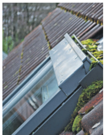
Wenn das Regenwasser nicht mehr richtig ablaufen kann, sucht es sich seinen Weg ins Innere. Im Worst Case weicht die Dämmung auf, und es droht ein erheblicher Schaden an der Bausubstanz. Foto: DJD/TLS-Dachfenster
